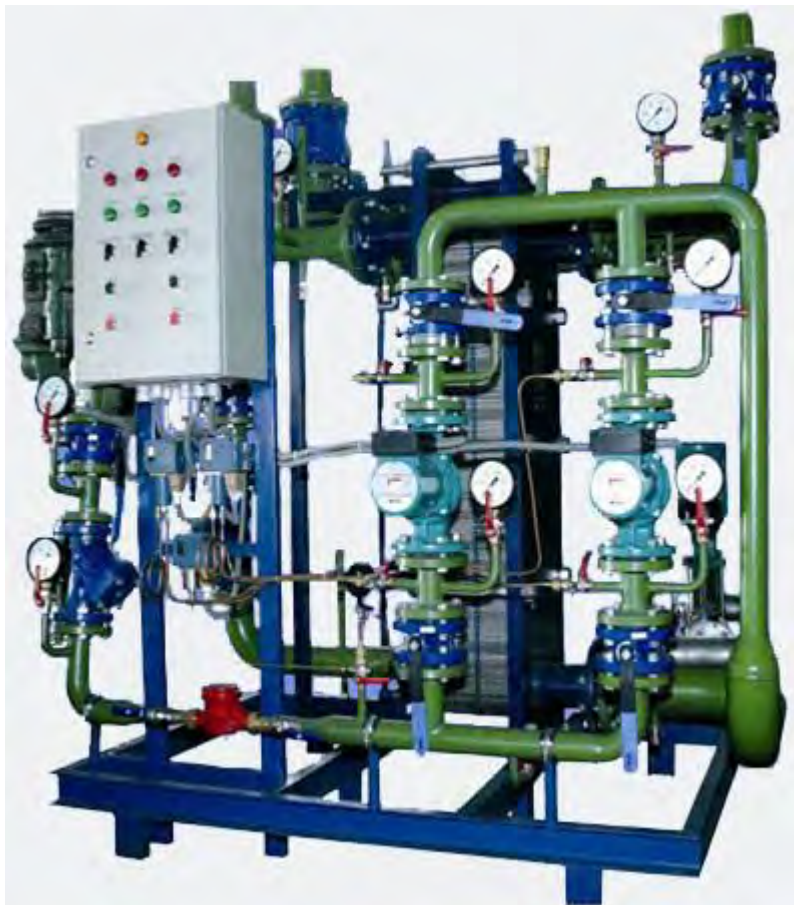
Рисунок 4.1 - Автоматизированный тепловой пункт
